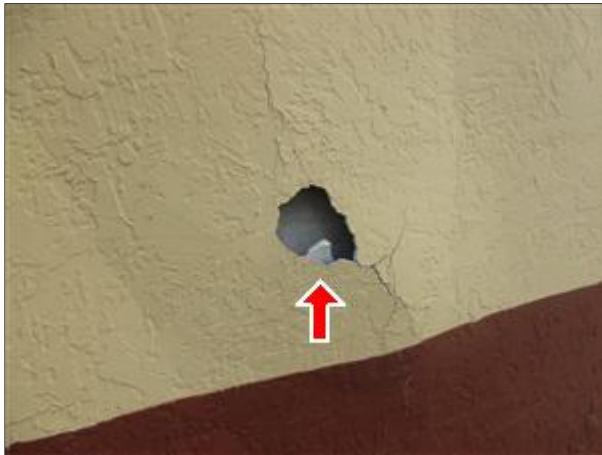
Spalling Stucco - Exterior
