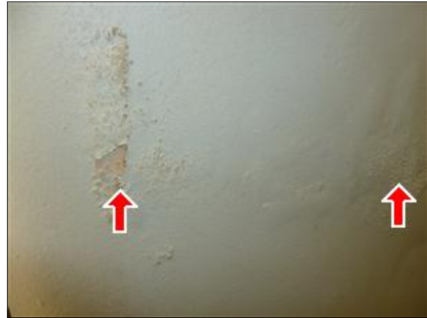
Moist Wall - Suite 3
