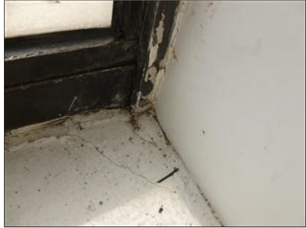
Damaged Door - Suite 3
