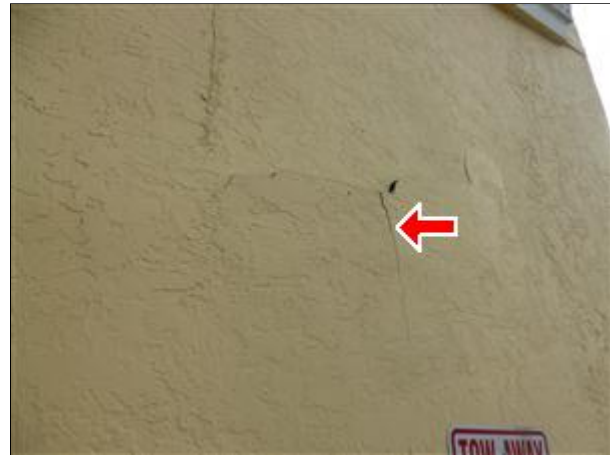
Spalling Stucco - Exterior
