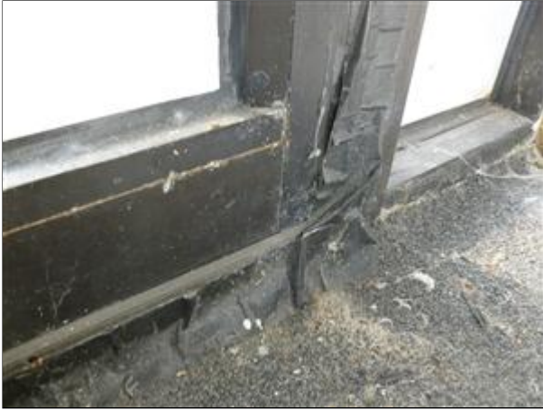
Damaged Door - Suite 3
