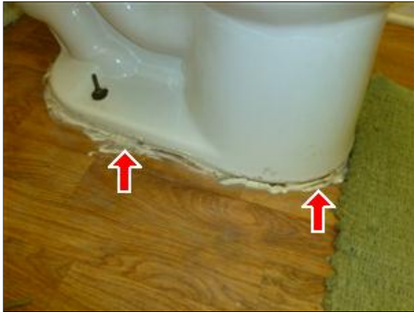
Toilet Caulking - Suite 2
