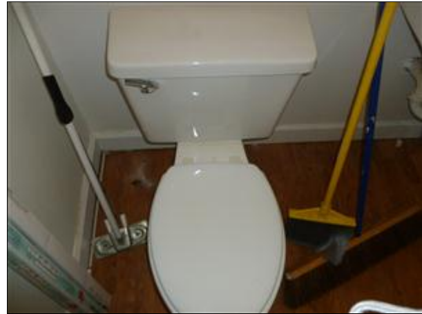
Inoperable Toilet - Suite 2
